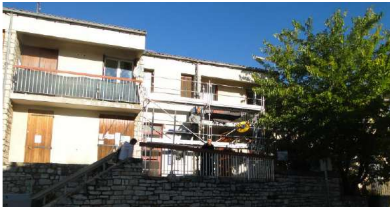
Installation d'un échafaudage sur la façade du bâtiment qui permet de maintenir la Poste ouverte
